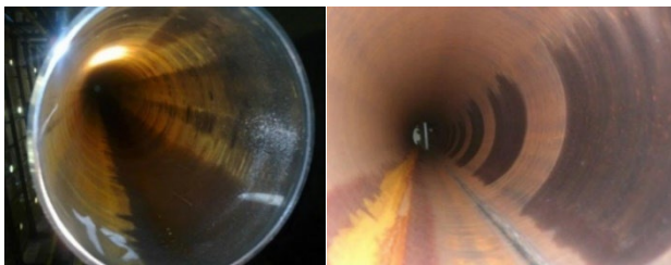
Рис. 2.73. Неприпустимі жирові забруднення поверхні труб
