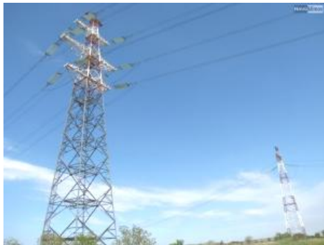
Берегова перехідна опора 330 кВ
