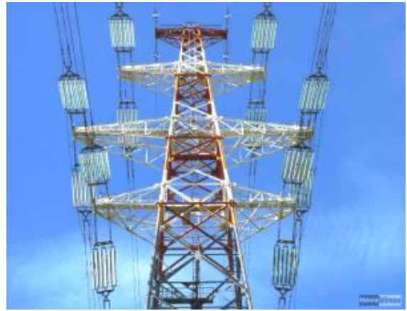
Верхівка перехідної опори 330кВ
