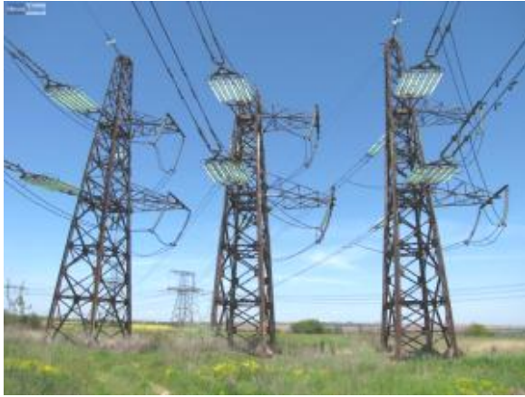
Кінцеві опори 330 кВ
