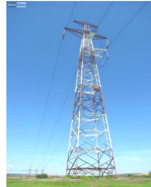
Берегова перехідна опора 750 кВ
