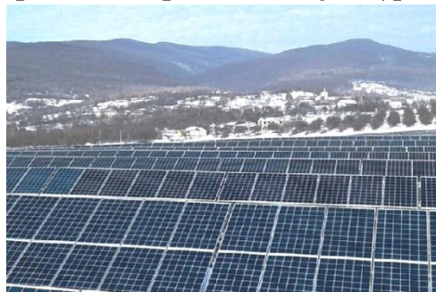
Рисунок 4.38 – Сонячна станція з фотоелектричними модулями
