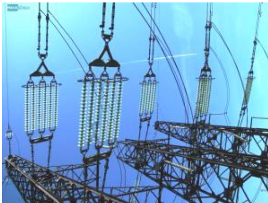
Кінцеві опори 330 кВ
