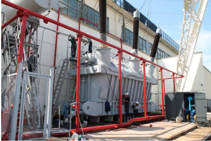
Рисунок 1.2 – Блочний трансформатор ТЕС, що підвищує напругу після турбогенератора (ТГ)
