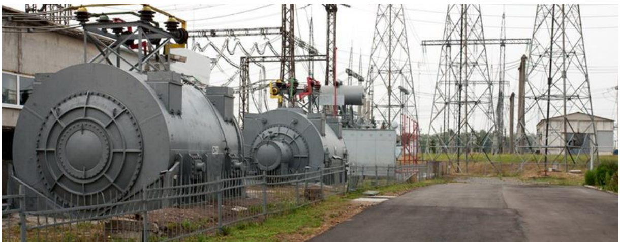
Рисунок 9.2 – Синхронні компенсатори, що встановлені на ВРП підстанції
