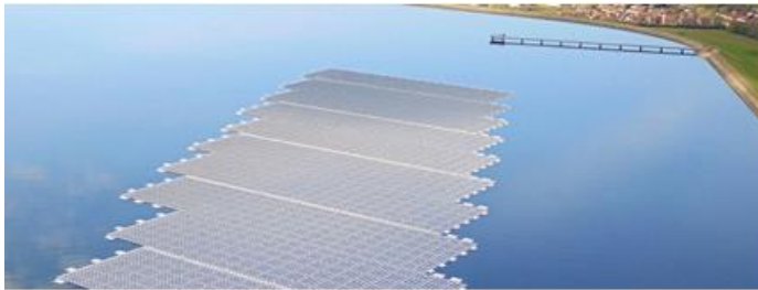
Рисунок 4.44 – Плавучі сонячні електростанції
