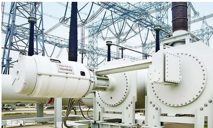
Рисунок 6.10 – Розподільний пристрій надвисокої напруги з елегазовою ізоляцією
